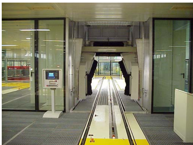
EMU – Karosserie-Reinigungsanlage zur Reinigung der Karosserie vor dem Lackierprozess
