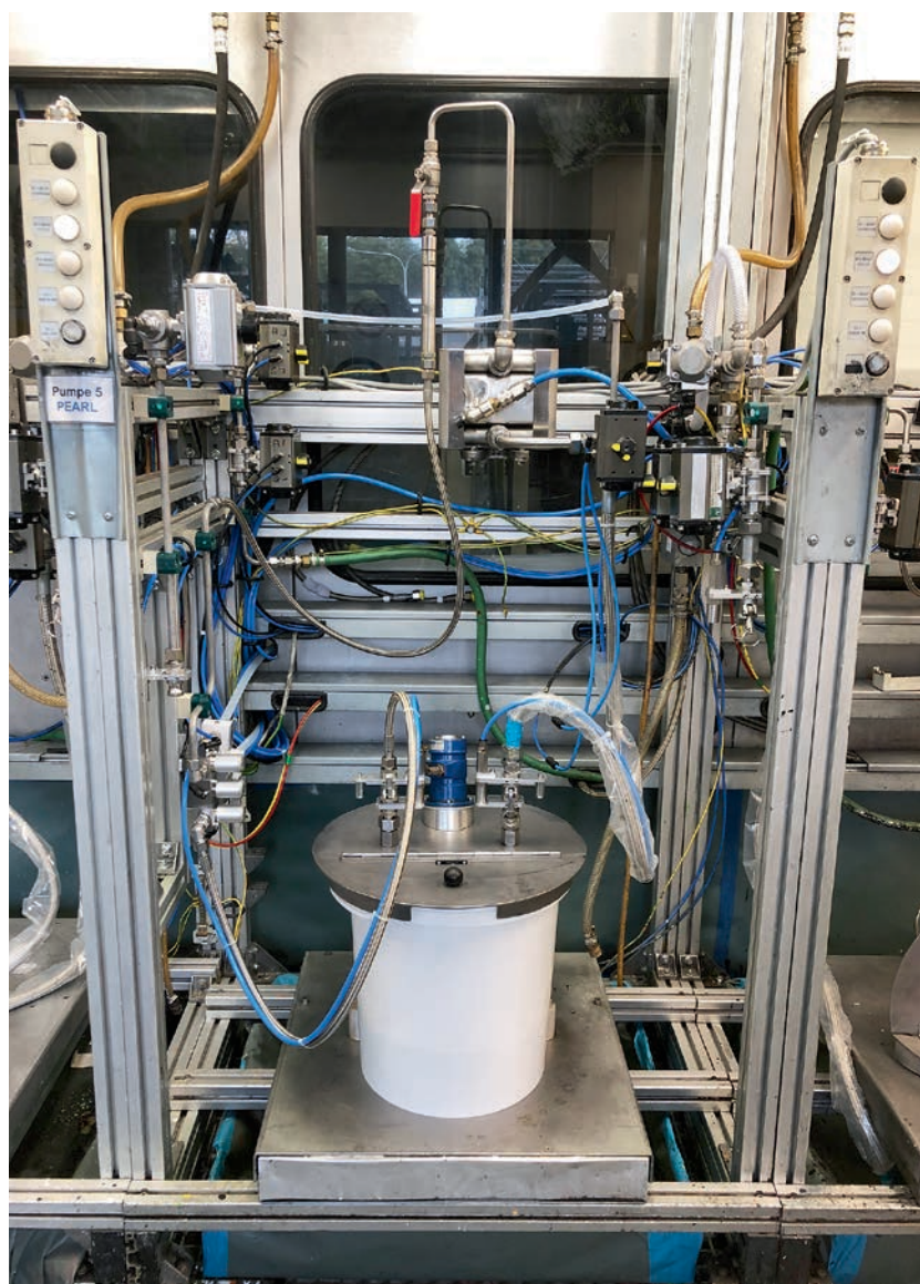
Sonderfarbversorgungsstation nach dem Umbau.
